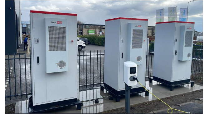
Duiven NL, 100kW/ 300kWh, November 2024
