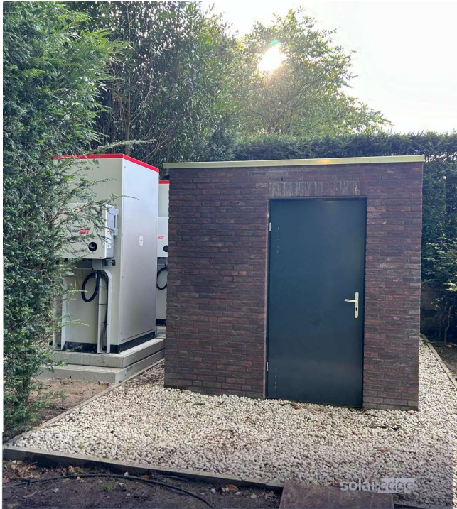
Oisterwijk 100kW/200kWh Oktober 2024
