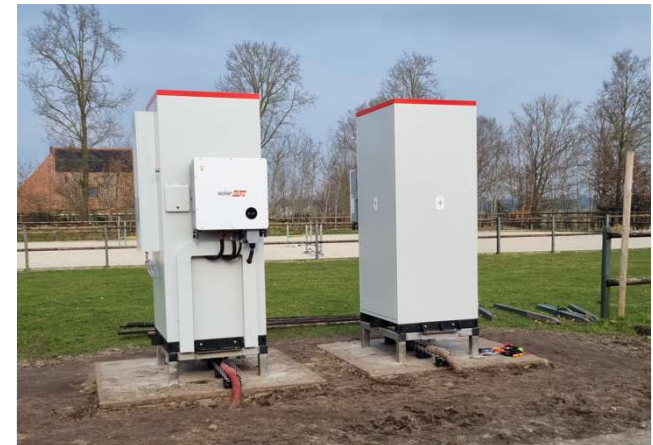
Oldeholtwolde, 100kW/ 200kWh, Februari 2025
